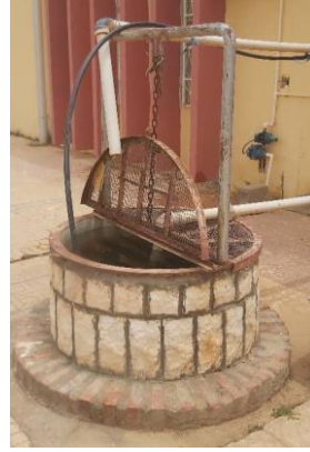
صورة 136: بئر ارتوازي لاستخراج مياه جوفية
