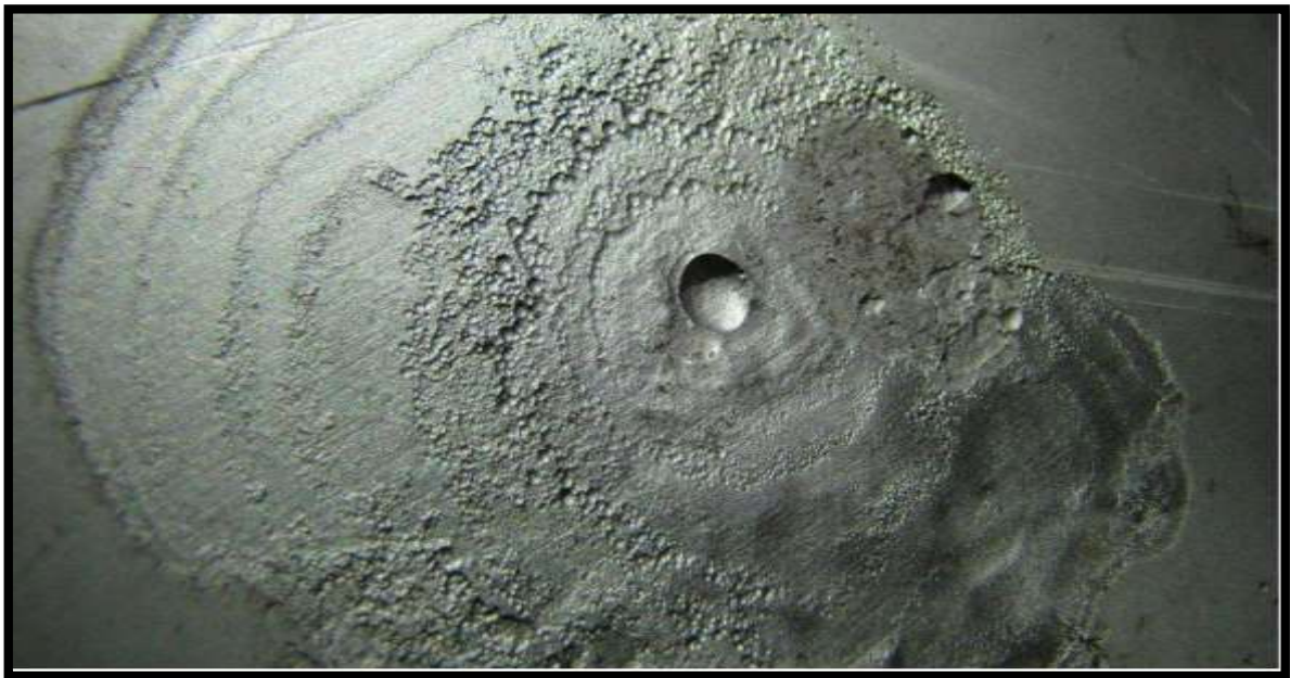
Figure I- 6 : Corrosion par Piqûres [15].
