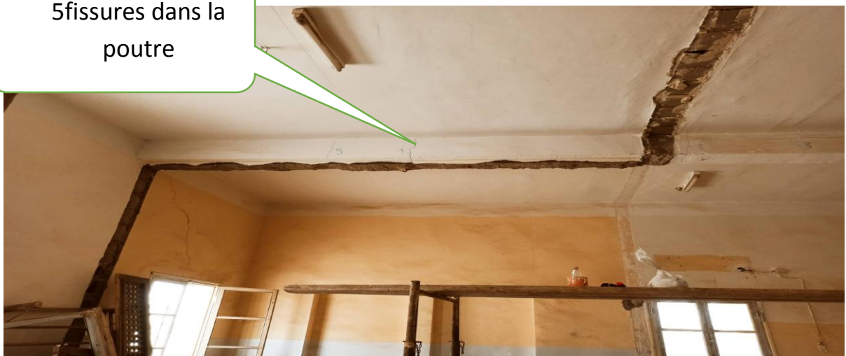
Photo 2.27. Fissures dans la poutre et l'isolation
