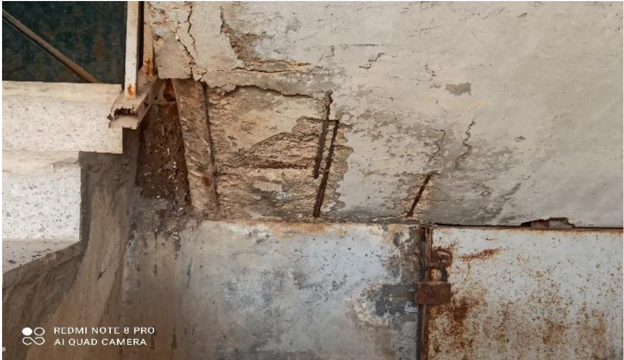
Fig. 1.3- Délamination de la paillasse d'un escalier en béton armé.
