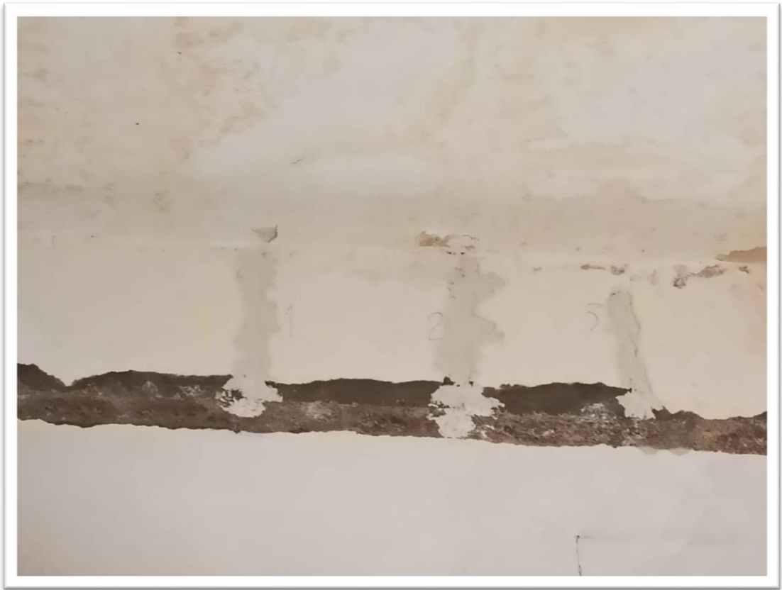
Photo 2.31 fissures après le teste de plâtre
