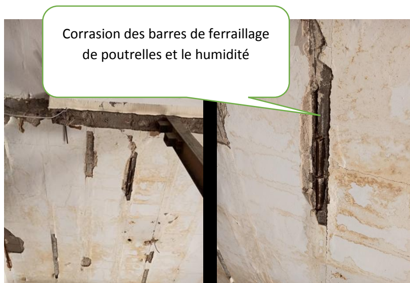
Photo.2.36. Corrasion des barres de ferrailage de poutrelles et le humidité
