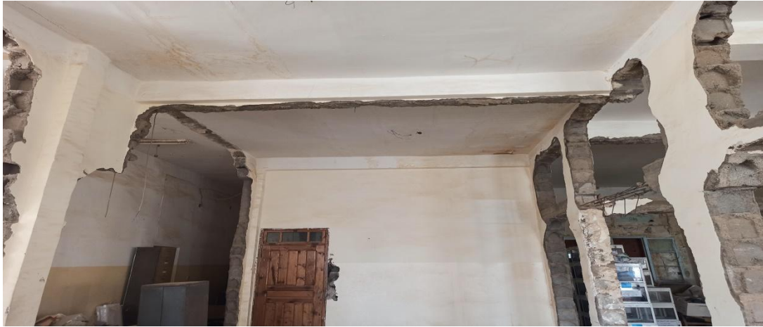
Photo 2.25 : l'absence des appuis
