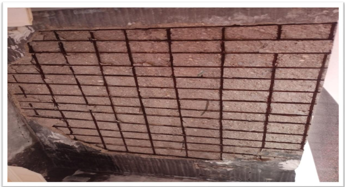
Fig. 1-2. - Délamination dues à la corrosion dans une dalle en béton armé.
