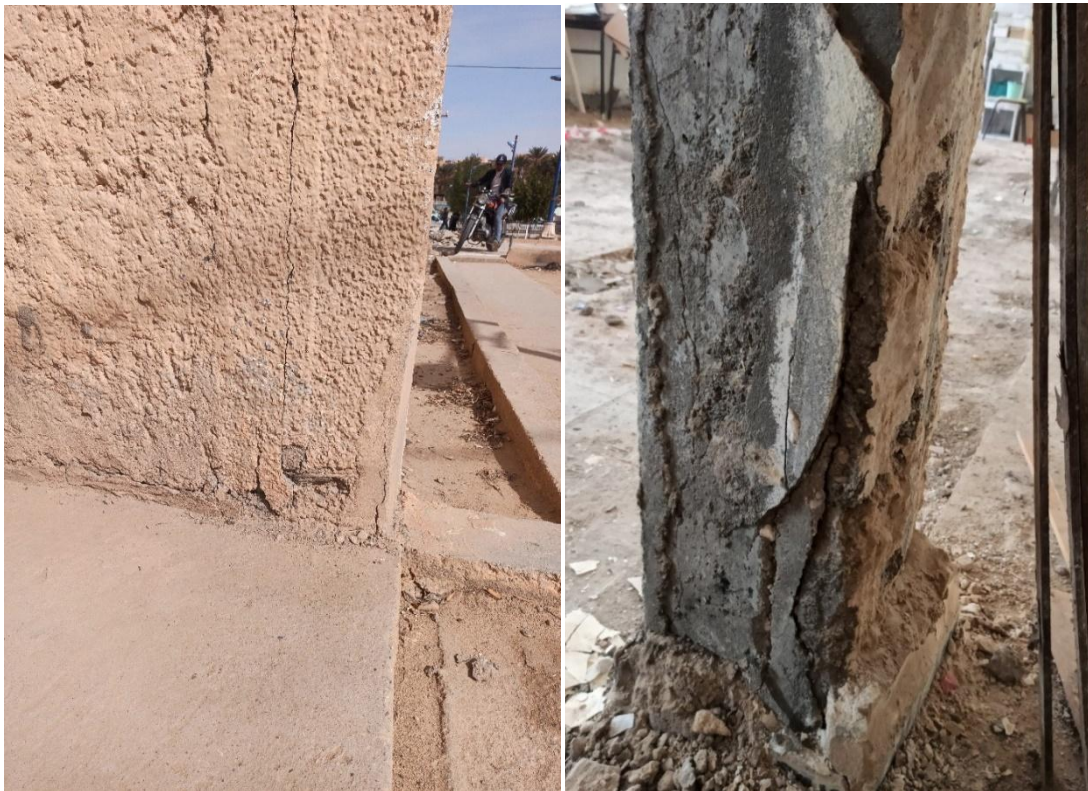
Photo 2. 4-5-6-7 : état de gonflement en faisant de la corrosion des barres d'armature
