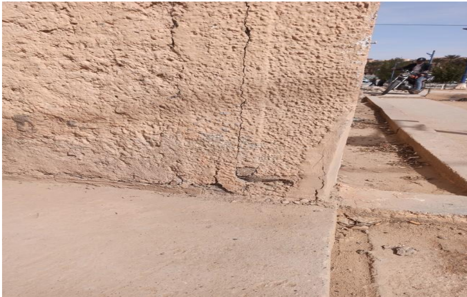
Photos 2. -15- : . échantillon de poteaux corrosif
