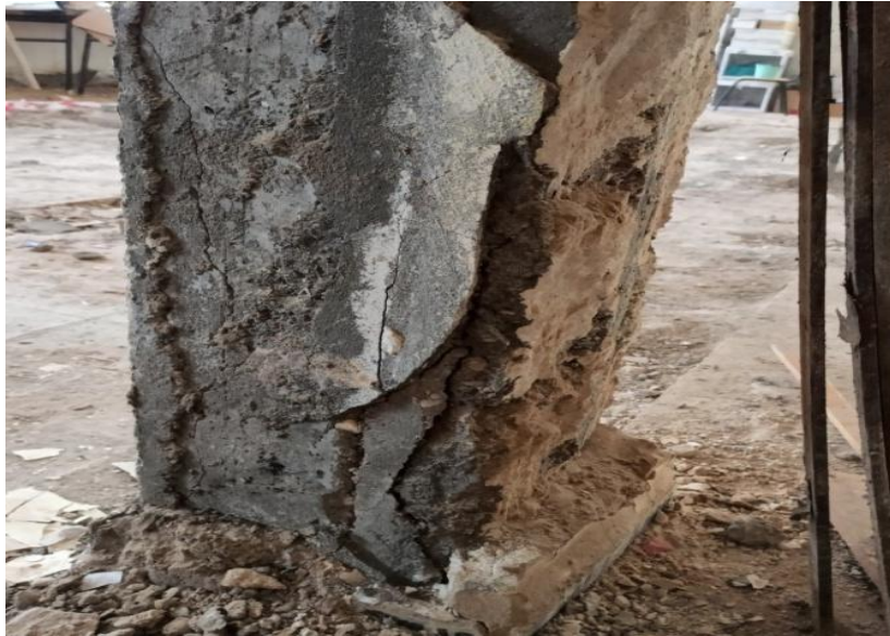
Photo 2. 18- : . Poteaux E3 avant test de marteau
