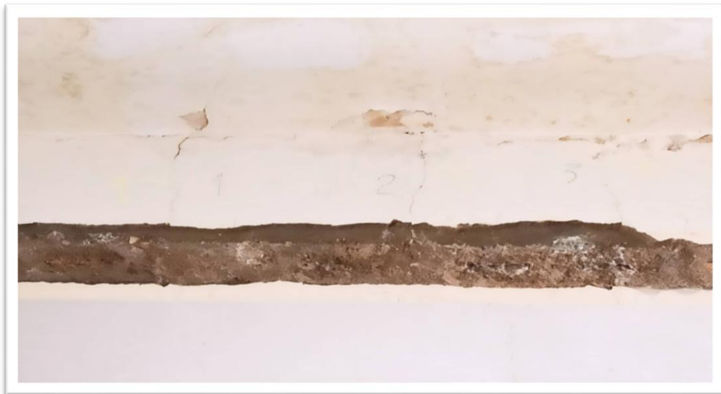
Photo 2.30 fissures avant le teste de plâtre
