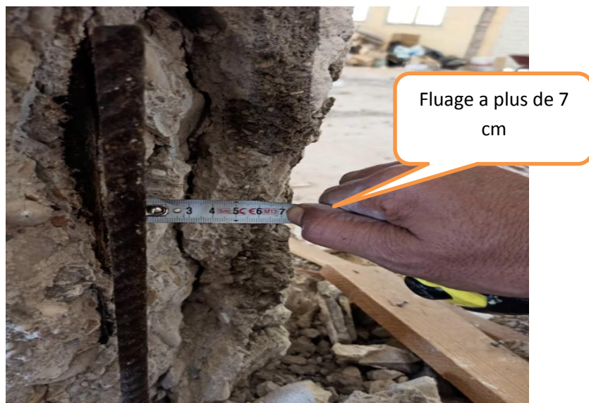
Photo 2. 20 : . le gonflement à plus de 7 cm
