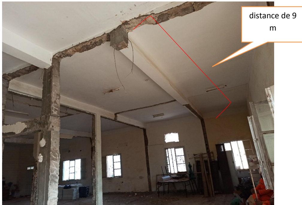
Photo 2. 03 : absence d'appuis à la grande distance de 9 m
