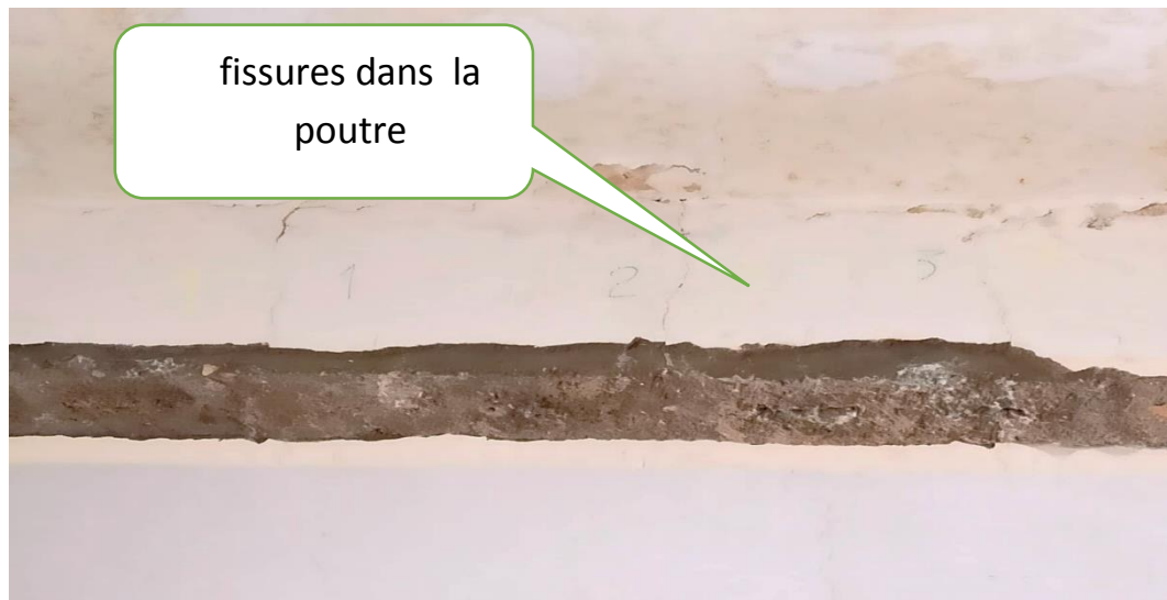
Photo 2.23 :. les fissures dans la poutre
