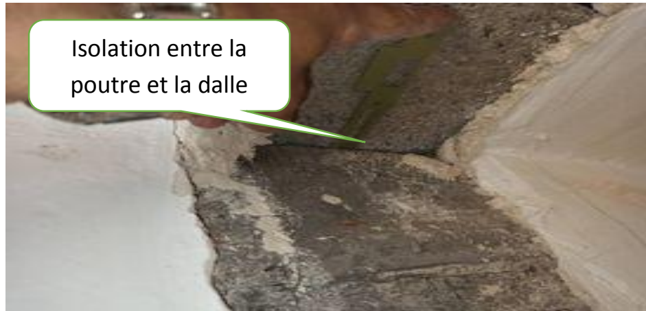
Photo 2.28. fissures dans la poutre et l'isolation
