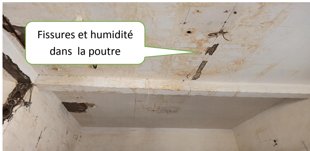
Photo 2.24 : les fissures et humidité
