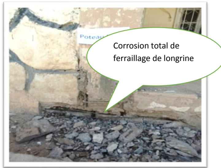
Image2.37. Corrosion total de ferrailage de longrine
