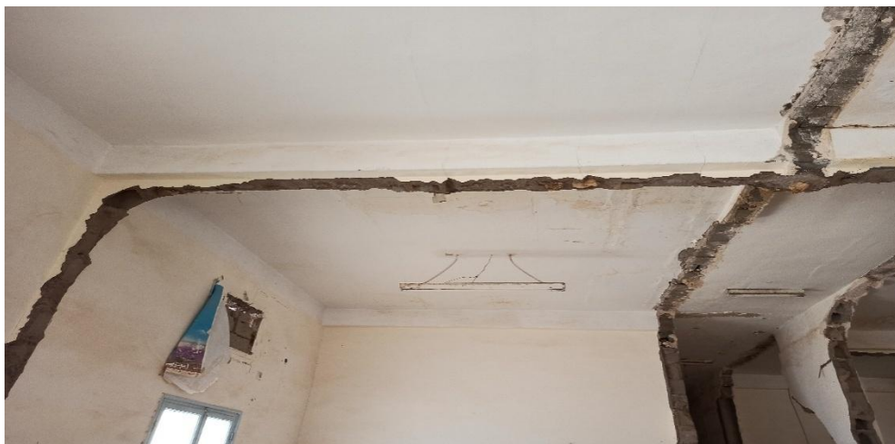
Photo 2.26 : fissures et humidité dans la poutre
