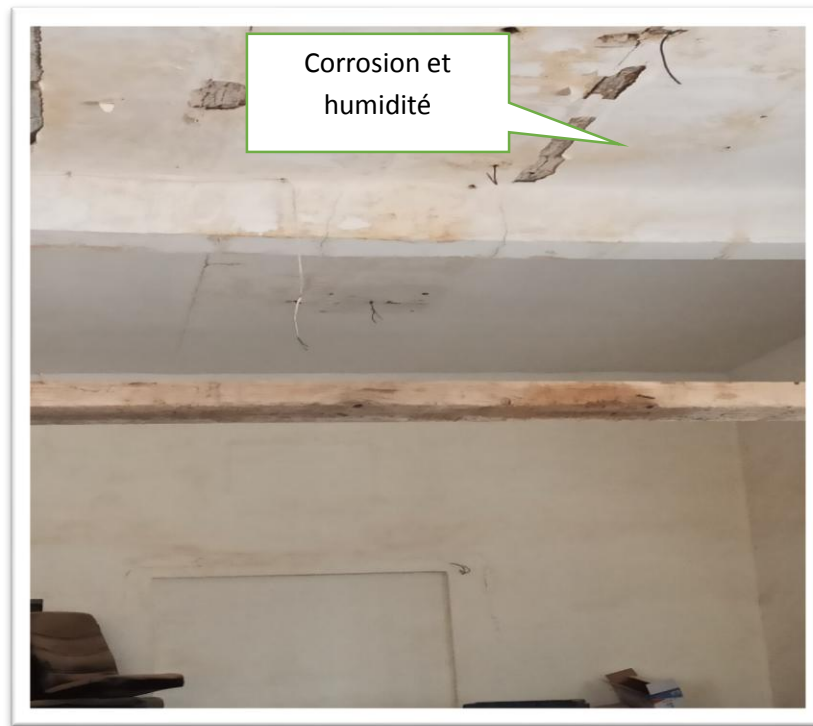
Image 2.8 : Une image montrant l'état de la corrosion des barres d'armature de poutrelles
