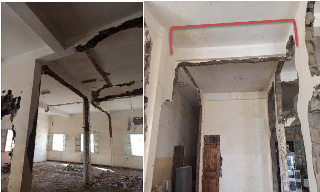
Photo. 2.2- absence de quelques colonnes aux endroits nécessaires
