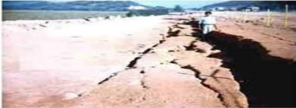
Figure I.7 : rupture des remblais sur sols compressibles. (12)
