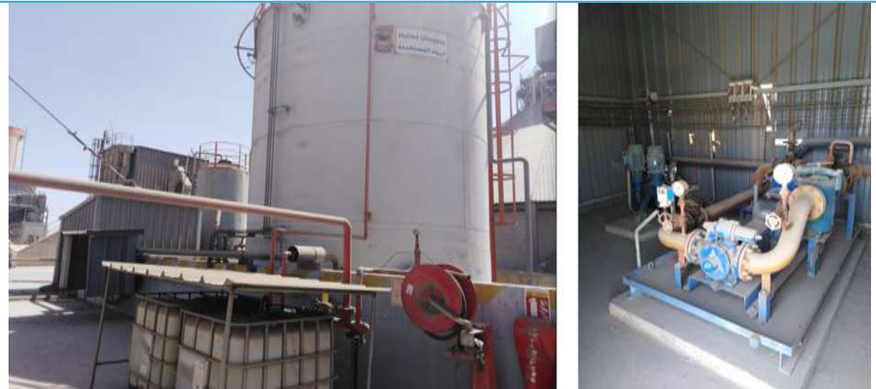
Figure IV.7. système d'injection huiles usagées dans le four (autre cimenterie)
