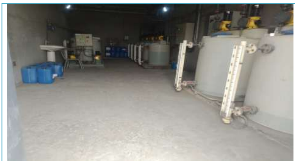
Figure III.2. Station de traitement des eaux usée
