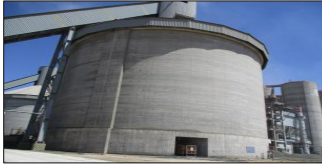
Figure I.120 : silo de clinker
