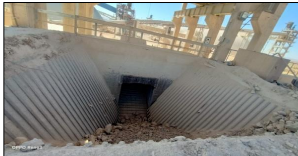
Figure I.10 : concasseur de calcaire
