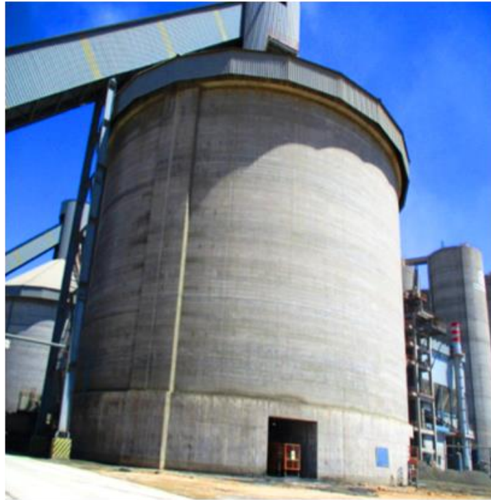
Figure I.25 : Un Silo de stockage de clinker.
