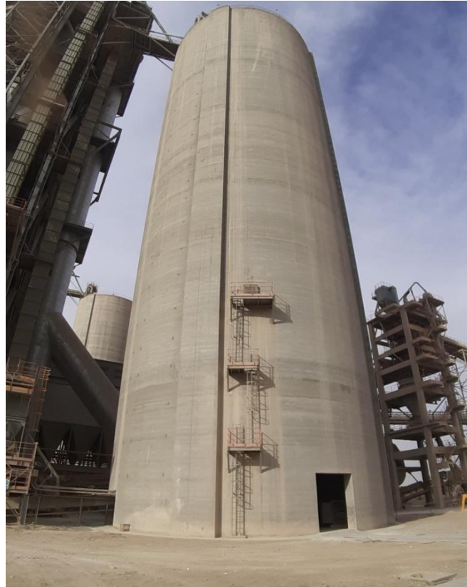
Figure I.11: Silo de stockage et d'homogénéisation.
