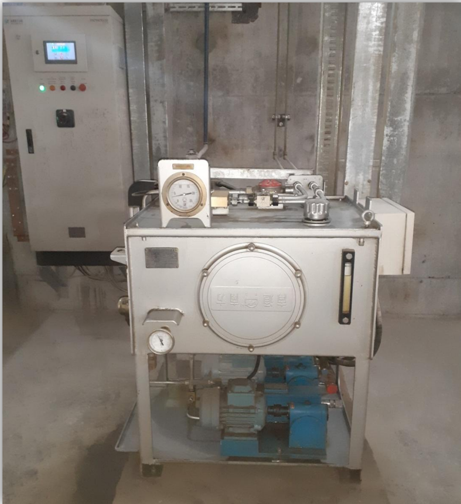
Figure III.1 : La station hydraulique de la roue de butée
