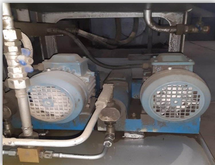
Figure III.4 : Les deux pompes
