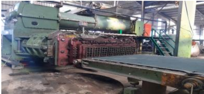
Figure I-4. Vue général sur la partie façonnage.
