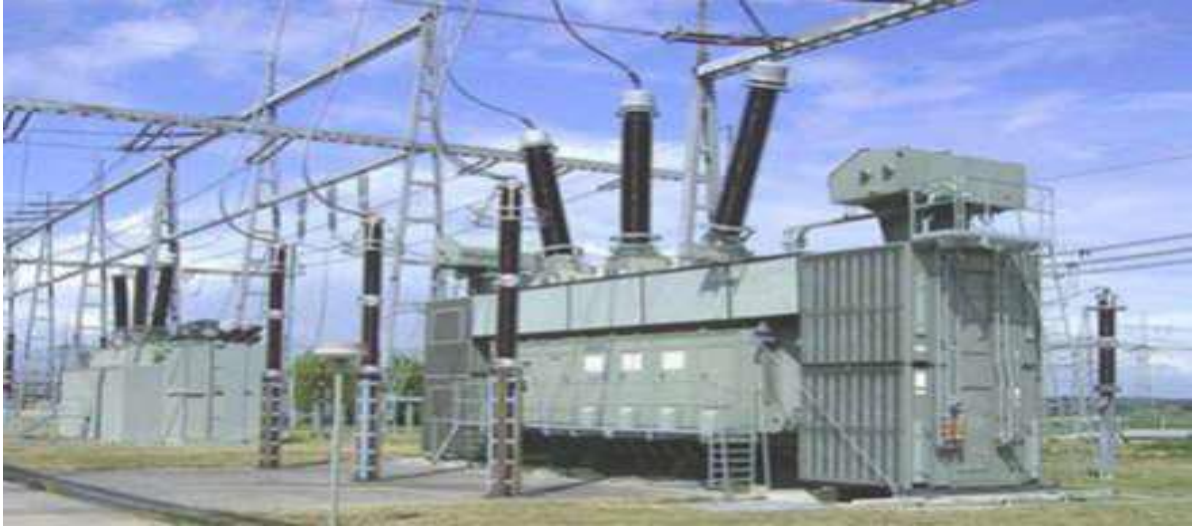
Figure I.12 : Transformateur de puissance d'un poste électrique HT.[6]
