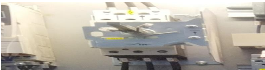
Figure III.9. Un grand disjoncteur sectionneur.
