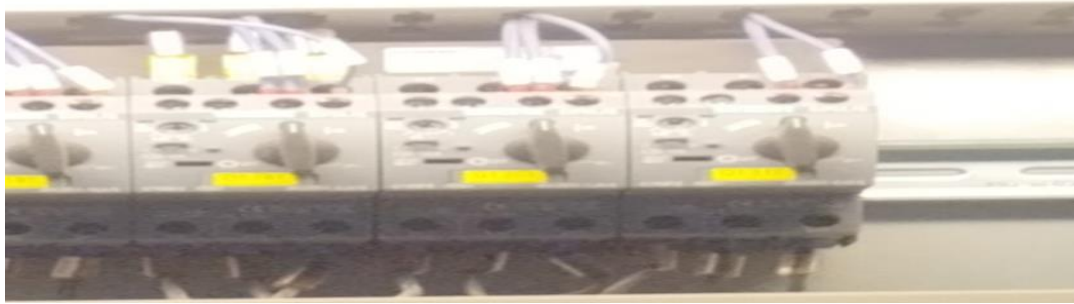
Figure III.10. Disjoncteur de puissance.
