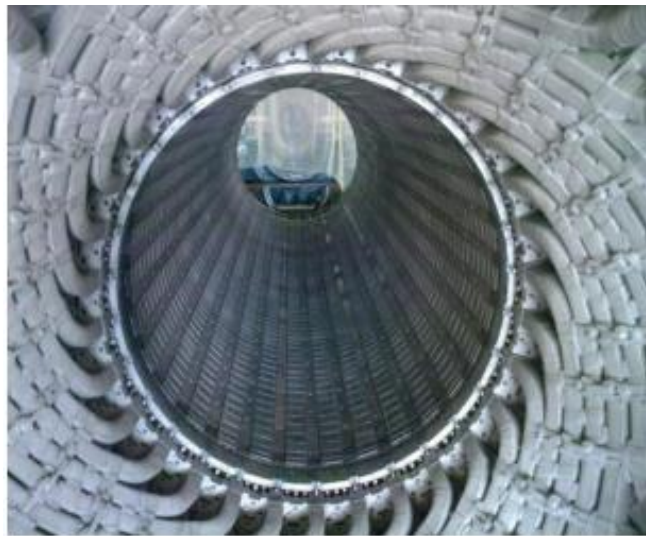
Fig. II.2 Enroulement du TIB-200-MT3 (alternateur de la centrale thermique de Jijel).
