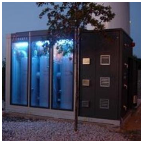
Figure I 15 FCL Vattenfall – Source : Nexans.fr
