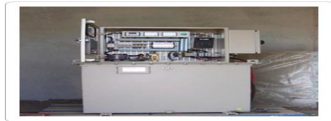
Figure. II.9: poste de soutirage à bain d'huile
