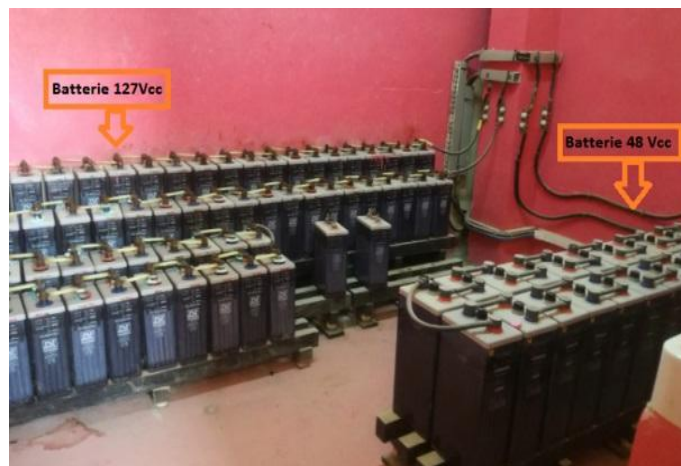
Figure I.13: Batteries 127 et 48 Vcc : GRTE –Biskra [6]
