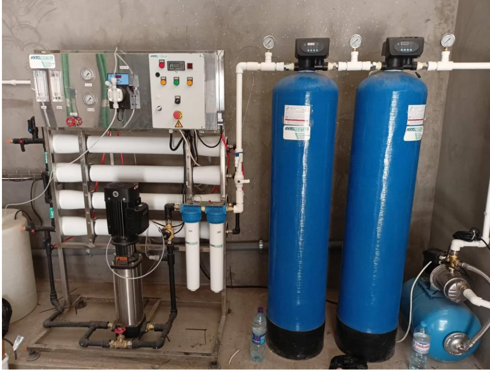
Figure 51 : Unité réelle d’osmose inverse de capacité 1000 l/h photo prise sur lieu du chantier dans l’unité de conditionnement STB el Baraka (Tolga).
