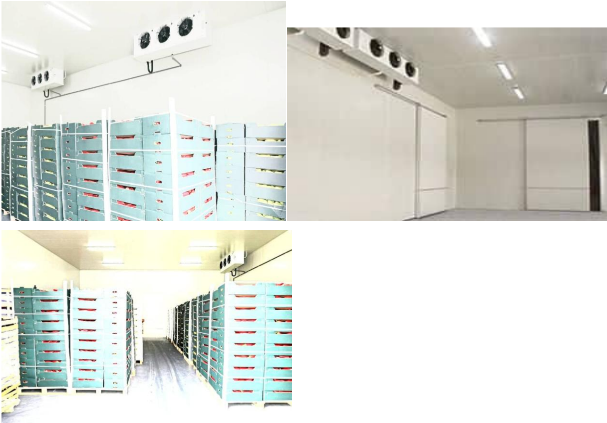
Figure21 : la forme de chambre de froid en groupe tahraoui (nova prim)
