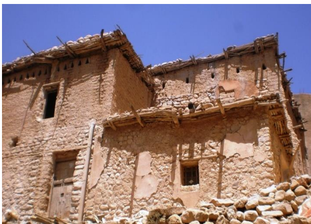
05- Maisons en cours de dégradation
