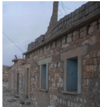
05- Maisons en cours de dégradation
