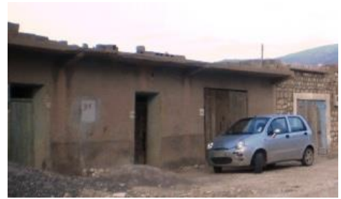
03 La modification d'aspect avec usage de matériaux modernes sans transformation du volume
