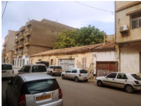
Figure V-106 : Maisons en cours de dégradation, (Source : Auteur ,2019)
