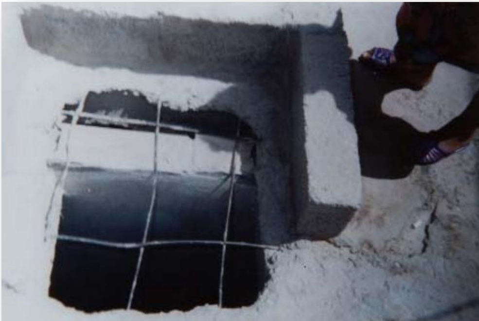
صورة 6.6 : صورة روزنة لمسكن حديث مفتوحة بطريقة عشوائية فوق جدار فاصل داخلي لإدخال الإضاءة الى مجالين مختلفين في ان واحد. كما نلاحظ الشبكة اللاصقة للبلاطة مكشوفة للخارج
