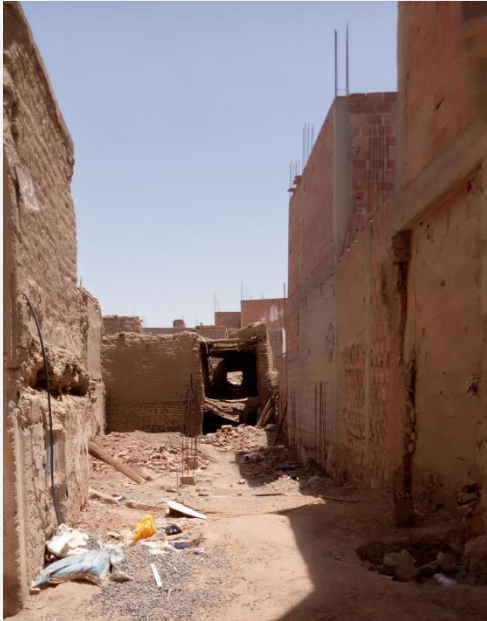
صورة 26.4 : صورة تبين الحالة المتدهورة لبعض المساكن الطينية المصدر: الباحثة 2016
