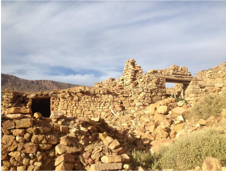
FIGURE 26: PHOTO MONTRANT L'ETAT DES MAISONS LES PLUS DELABREES ; SOURCE : AUTEUR.
