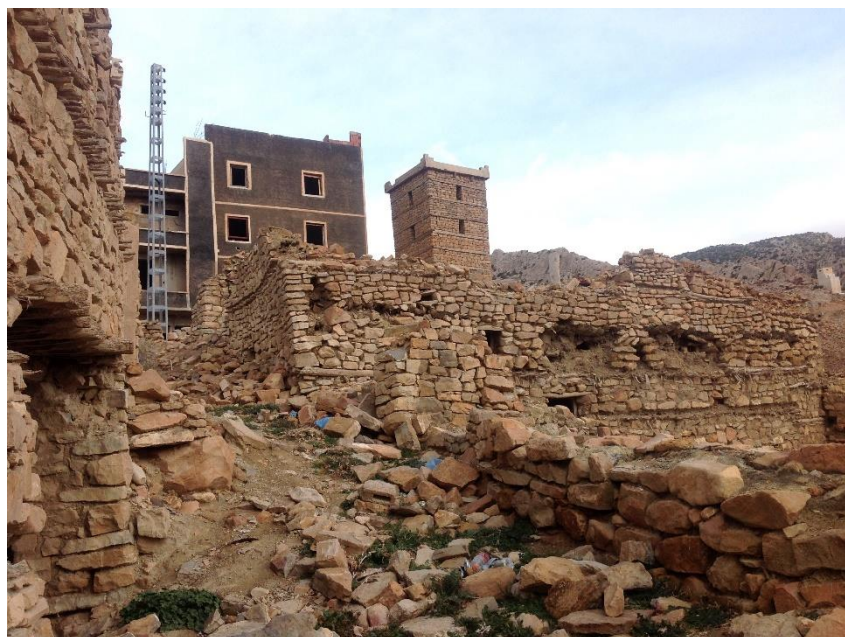
FIGURE 21: IMAGE MONTRANT LA HEUREUR DU NOUVEAU BATIMENT PAR RAPPORT AU MINARET DE LA MOSQUEE ; SOURCE : AUTEUR.
