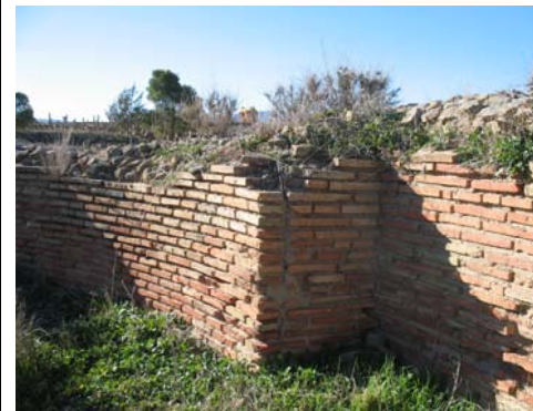
Fig. n°162, Destruction par l'insertion des câbles électriques
