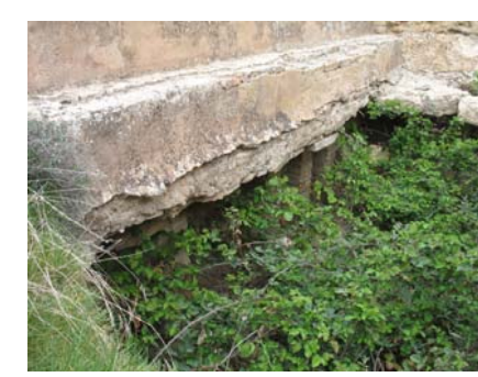
Fig. n°159, Destruction des structures des thermes du Capitole de Djemila
