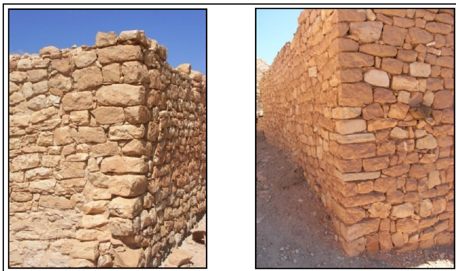
Figures 4.43, 4.44: Chainage d'angle entre murs. A gauche : maison à Tahamemt, à droite : maison des Bekhouche à Haourireth. (Source : Auteur, 2015)
