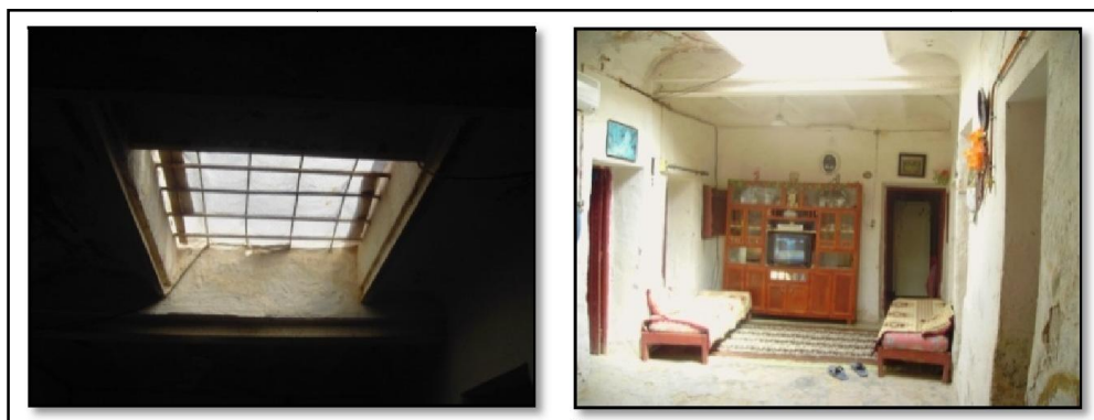
Figures 3.30, 3.31: Trou dans le toit au dessus d' āmissiddār et aménagement en sallon (Source : OGEBC Ouargla, 2013)
