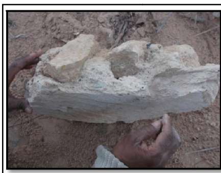
Figure 5.22 : Fragment de mur, Maison dégradée au ksar de Ouargla. (Source : Auteur, 2015)
