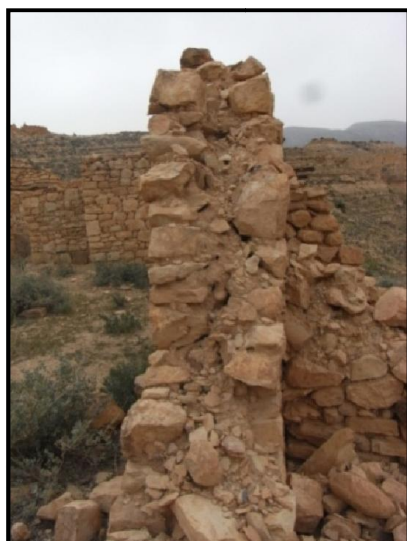
Figure 4.33: Coupe transversale sur mur de maisons en ruine à Hiza (Source : Auteur, 2015)
