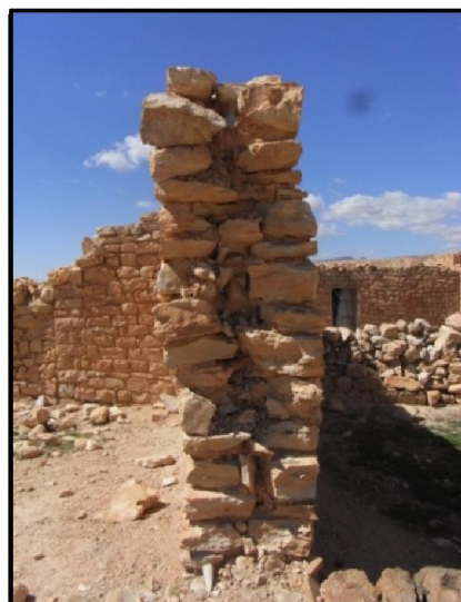
Figure 4.34: Coupe transversale sur mur de maisons en ruine à Tahamemt (Source : Auteur, 2015)
