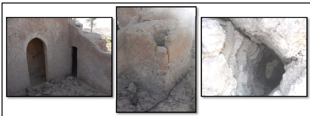
Figures 6.51: Salle d'eau avec conduit d'aération. Maison rurale à Lebdoue, Guemar. (Source : Auteur, 2015)
