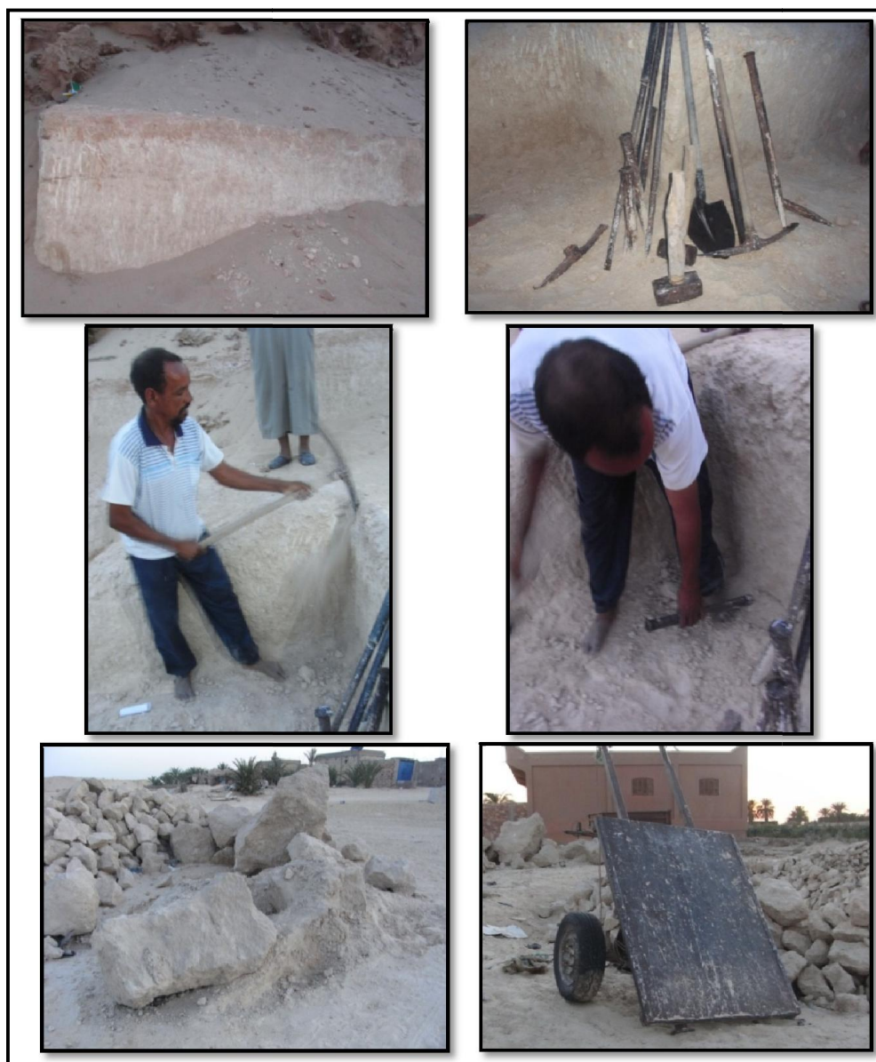
Figures 6.4: De haut en bas : sol façonné (tafza), outils utilisés ; méthode d'exécution des rainures ; blocs de pierre « tafza » extraits, carriole pour acheminement. Site El Gharbia, Guemar. (Source : Auteur, 2015)
