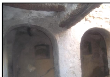
Figure 5.26: Structure intermédiaire en arcades sous patio. Maison faisant partie du projet 150 logements à réhabiliter au ksar de Ouargla. (Source : OGEBC Ouargla, 2013)
