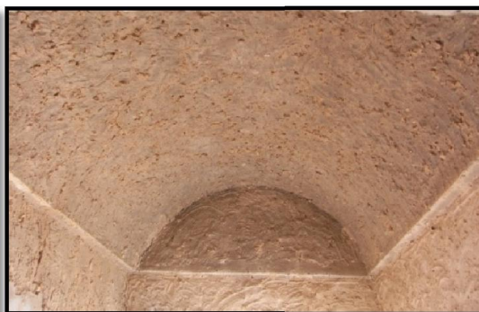
Figure 6.34: Revêtement intérieur voute à l'ancienne. Maison rurale à Lebdoe, Guemar. (Source : Auteur, 2015)
