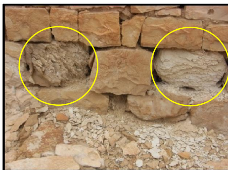
Figure 4.5 : Pierre de mauvaise qualité, dégradée. Maison Belaeiche à Hiza (Source : Auteur, 2015)
