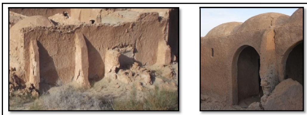
Figures 6.24: Contreforts (à gauche : mur extérieur, à droite : mur sur cour) Maison rurale à Lebdoe ,Guemar. (Source : Auteur, 2015)
