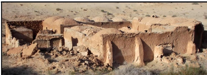
Figure 6.15: Configuration d'ensemble d'une maison rurale (à proximité de Ghout) à Lebdoe, Guemar. (Source : Auteur, 2015)
