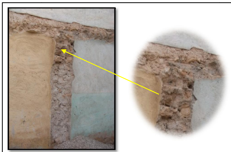
Figures 5.24 : Reste de mur (pierre de liaison).Maison démolie au ksar de Ouargla. (Source : Auteur, 2015)
