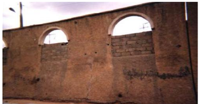
Fig. IV.8 : A la Cité El Amel, un traitement de façade inachevé.
