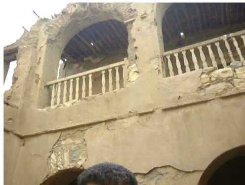
Photo. 64 : la dégradation du garde corps dans le patio
