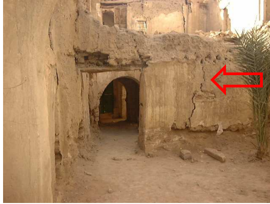
Photo. 38 : Les fissurations sur les murs résultat des lois universelles de la mécanique
