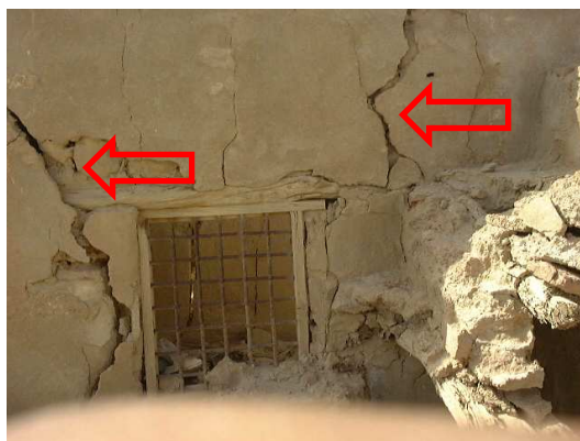
Photo. 40 : Les fissurations sur les murs résultat des variations de température
