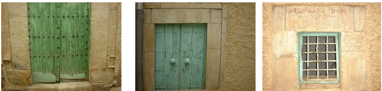
Photo.30: Les portes et fenêtres de la Mosquée Sidi Lembarek montrant le génie des bâtisseurs et la valeur des mosquées et zaouïa à Khanguet Sidi Nadji
