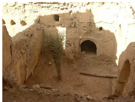
Photo. 59 : l'état des sols avant l'intervention
