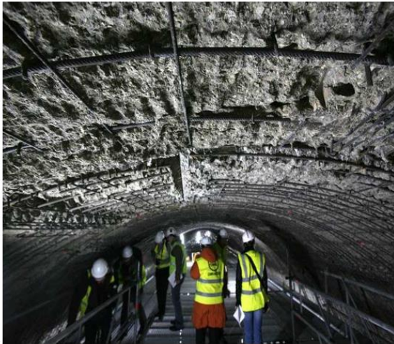
Tunnel Sous la Manche en phase de réparation à la suite de l'incendie de Septembre 2008, [Lejd, 2008].38
