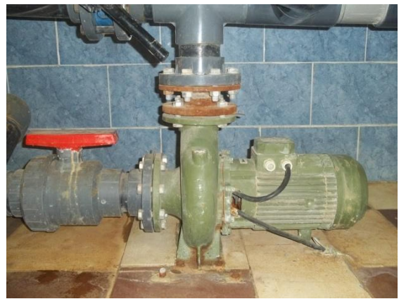
Photo I.5 : Photographie d'une Pompe centrifuge.
