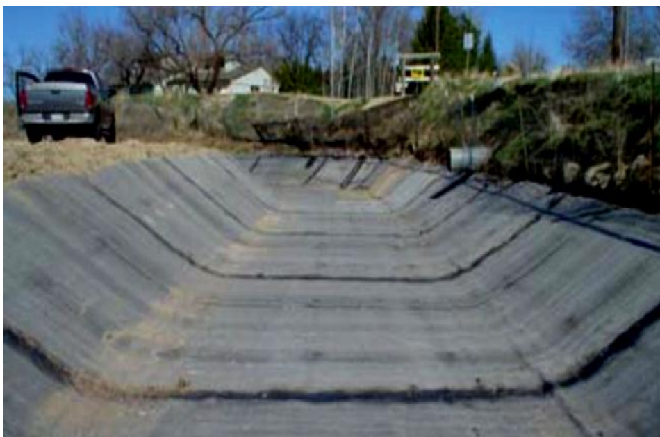
Fig. I.20 : Etanchéité du canal d'irrigation de Caldwell (USA) par les enrobés bitumineux ( http://www.coletanche.com/fr/references/hydraulique/canaux/canal-black-canyon-irrigation-district ).
