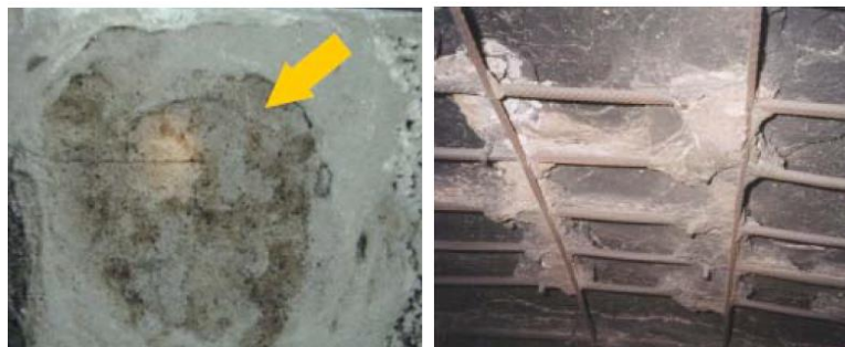
Figure I.25 Écaillage lors de l'incendie du tunnel mont blanc [Toumi ,2010]
