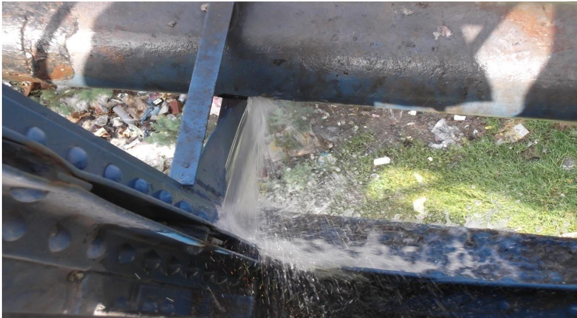
Photo II.1 : Conduite DN 250 acier noir venant de la station de reprise Timezghra vers le réservoir Imadalou
