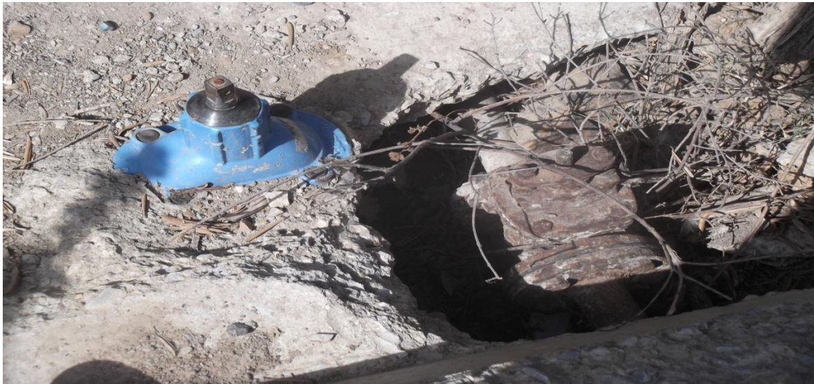
Photo II.3 : Vanne sur la conduite de distribution (Réservoir Hôpital)
