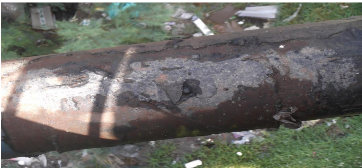
Photo II.2: Conduite d'alimentation en eau potable
