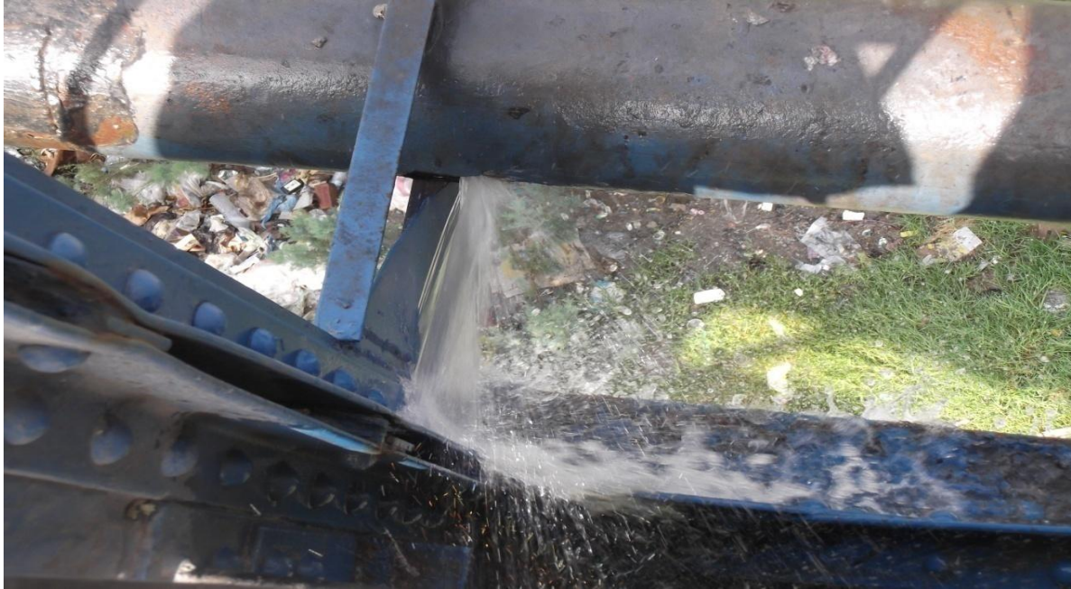
Photo II.1 : Conduite DN 250 acier noir venant de la station de reprise Timezeghra vers le réservoir Imadalou
