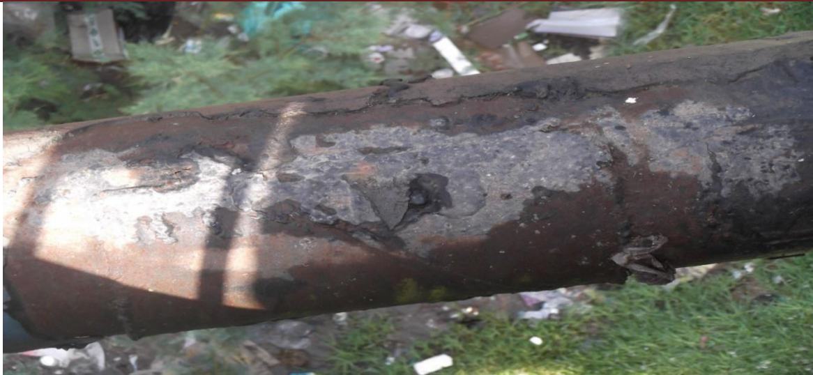
Photo II.2: Conduite d'alimentation en eau potable
