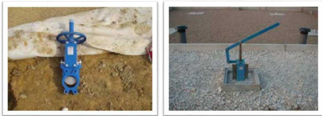
Figure 3.8: Photo. Des vannes pour la distribution sous-superficielle. (DADDH, 2012)
