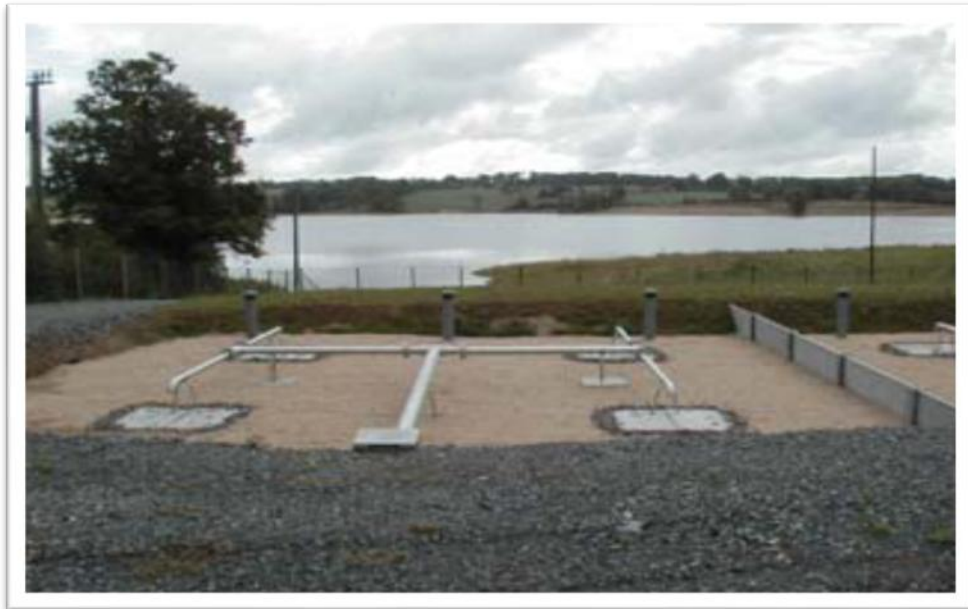
Figure 3.9 : Photo. Une conduite perforé pour la distribution sous-superficiel. (DADDH, 2012)
