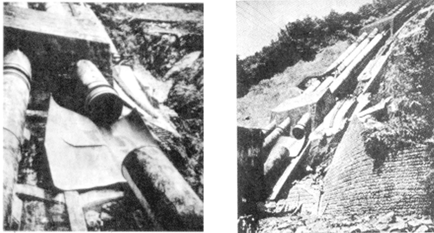
Figure (I.2) : Vue d'une conduite forcée éclatée de la centrale électrique d'Oigawa, du Japon (d'après Chaudhry, 1979)
