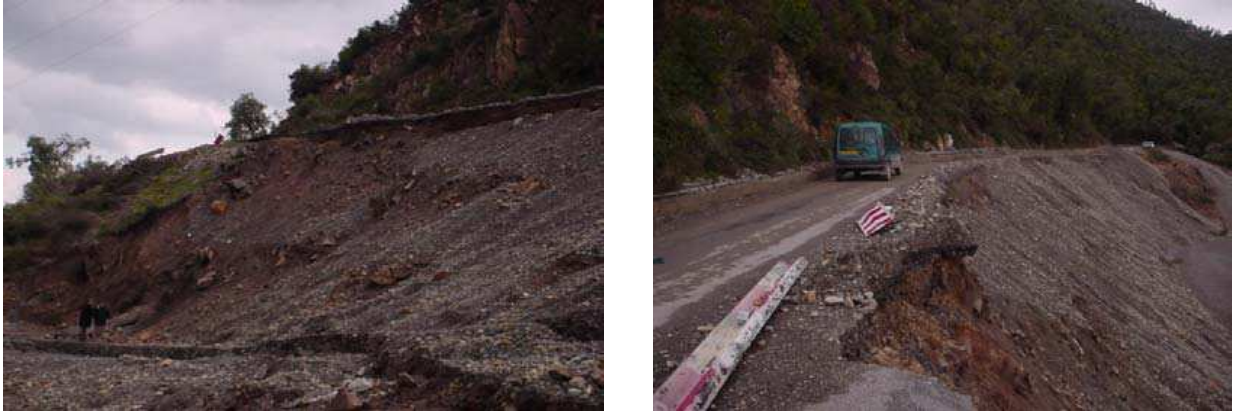
Figure 2.15 – Vue du glissement.
