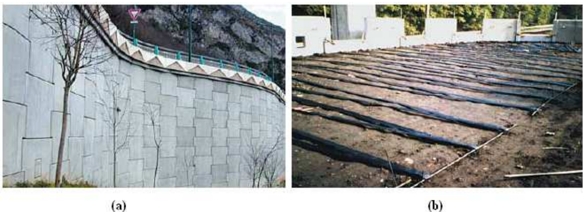
Figure 2.22 – (a) Ouvrage renforcé par bandes avec un parement de type écailles. (b) Exemple d'ouvrage renforcé par bandes.
