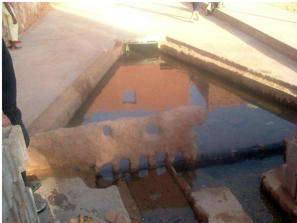
Fig. XIII. 23. Le peigne d'une Kasria tertiaire détruit (Remini B., 2007)
