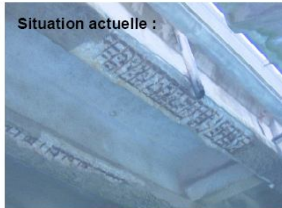
Phot. 1.1- Mise à nu d'armature en sous face d'un pont à poutres. [8]
