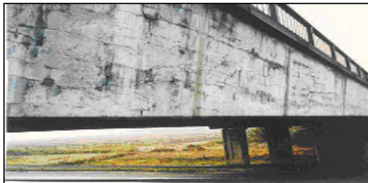
Figure 3.05 : Fissuration dans l'ouvrage dû la réaction alcali-silice
