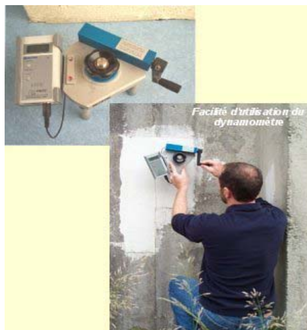
Photo (1.12) : Le dynamomètre Mesure de l'adhérence d'un revêtement sur pierre ou béton durci
