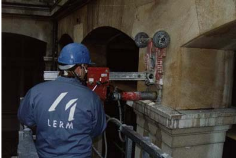
Photo (1.13) : Carottage électrique à la couronne diamantée de 20 à 110 mm de diamètre Equipement complet pour les prélèvements : carotteuse, scie diamantée
