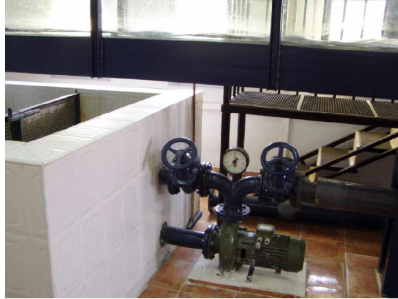
Photographie 3.3 : Vue de la pompe axiale utilisée insérée dans la conduite circulaire à l'aval du bassin de récupération des eaux
