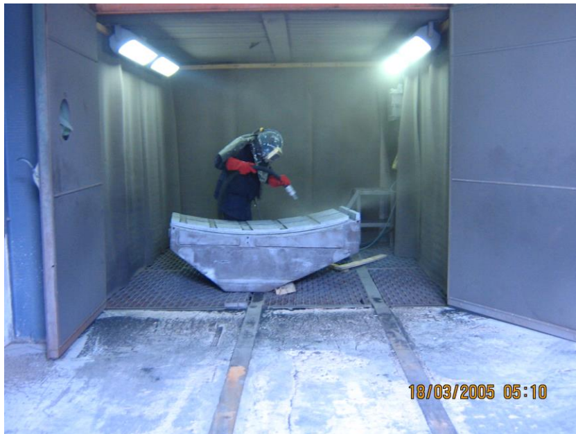
Figure7 : Poste de sablage (MEI)
