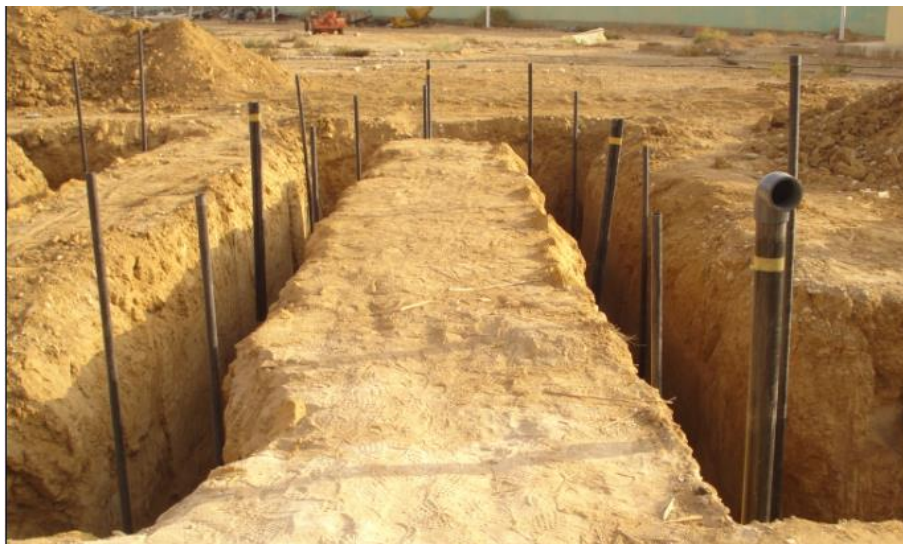
Figure 1. Vue générale de l'échangeur air sol.
