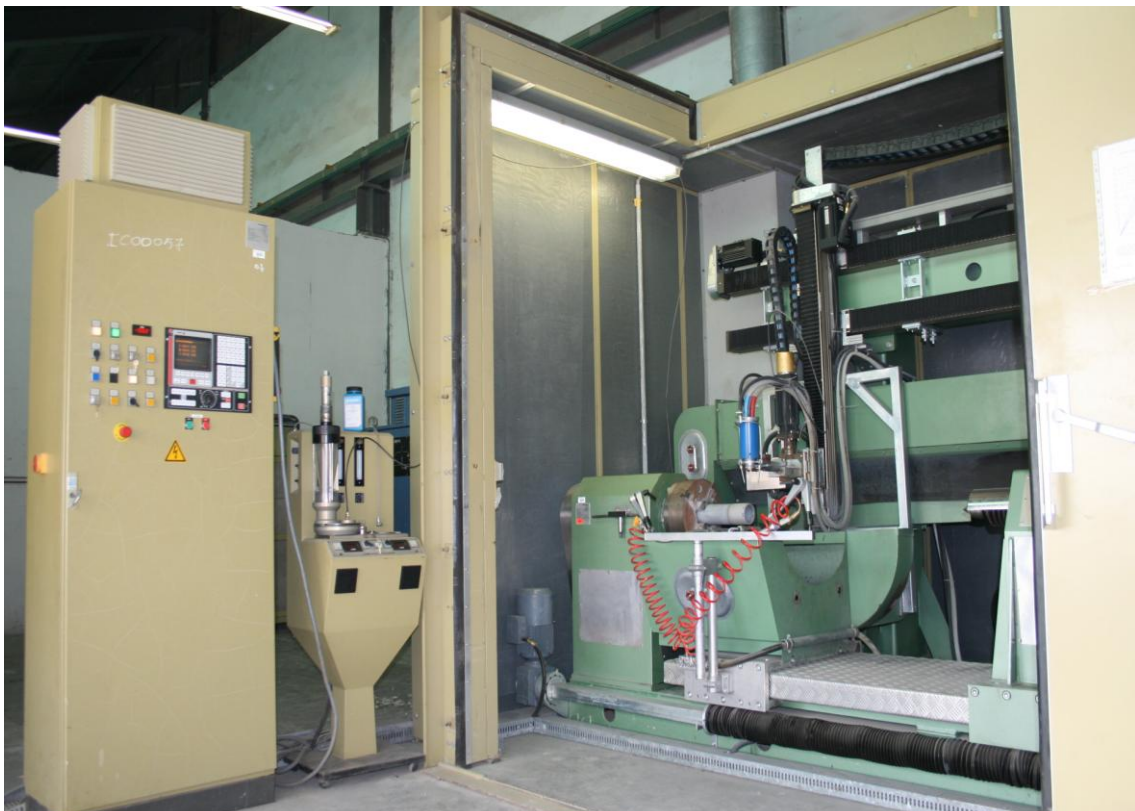
Fig. II.9 : Poste de métallisation par plasma d'arc (MEI).
