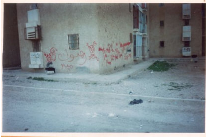
Photo N°13 : La façade un support de graffitis
