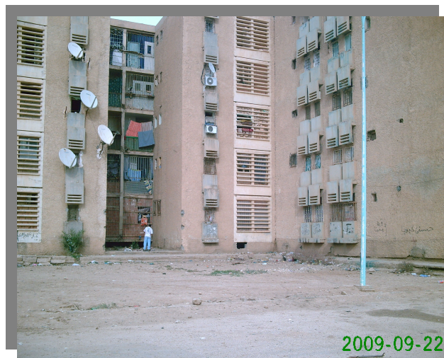
Photo N° 31 : Etat déplorable des espaces extérieur dénudé et de la façade
