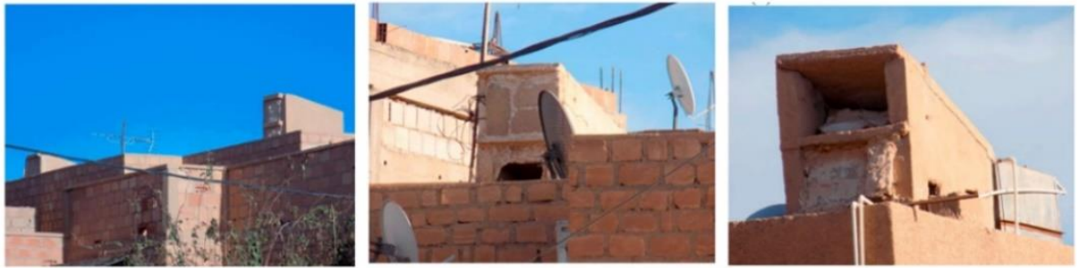
Figure 4-13 : exemples de Malquafs obstrués de la cité des 200 logements à Ouled djellal (source : Kaihoul & al. , 2021)
