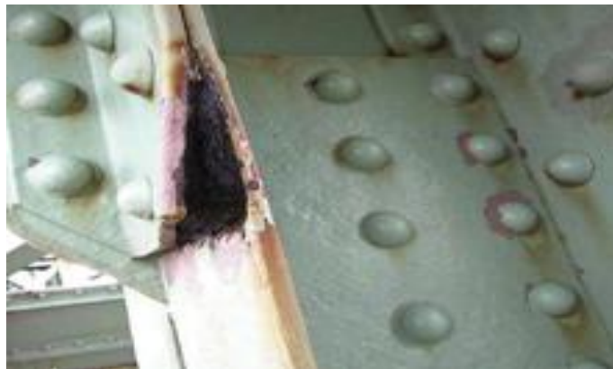
Fig. I.4. La corrosion caverneuse.
