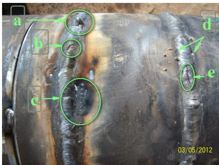
Figure 90 : Cordon de soudure avec les défauts (cratère, morsures/caniveaux, Fissure, Amorces d'arc).
