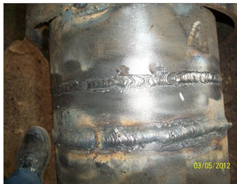
Figure 68 : Etat du cordon de soudure après brossage.
