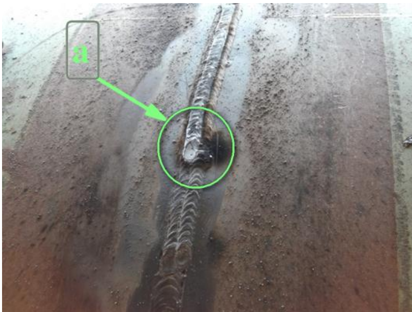
Figure 96 : Cordon de soudure avec les défauts (cratère).
