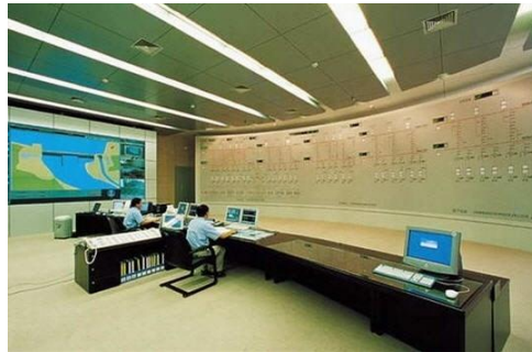
Fig. II.6: Salle de contrôle
