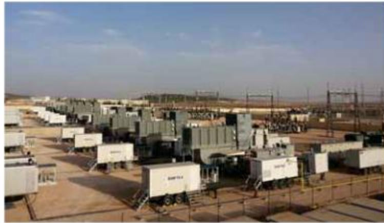
Fig. I.7 Exemple d'une turbine à gaz mobile pour la production de l'électricité en Algérie
