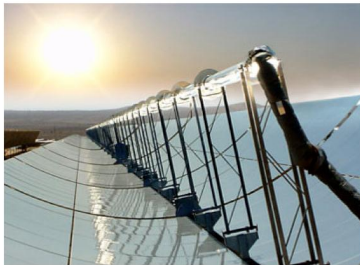
Fig. II-1 concentrateur cylindro-parabolique de la centrale Nevada solar one (USA).
