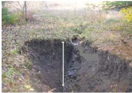
Concentration d'eau (ravinement)
