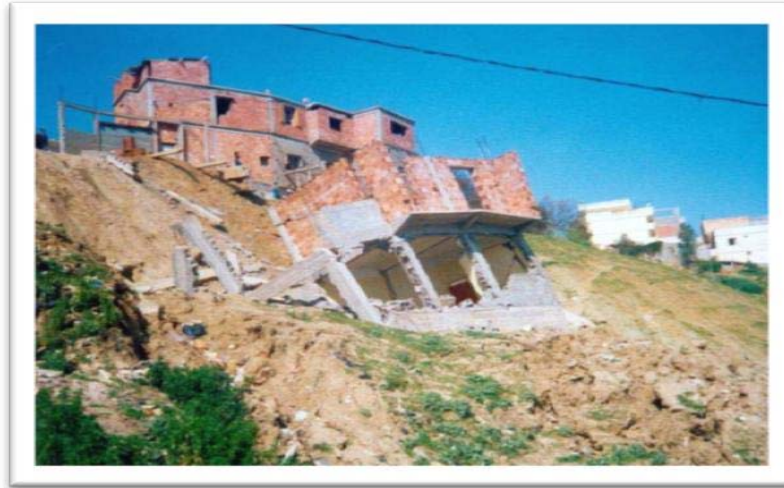
Figure1.28 : Glissement de Tizi quartier de Bejaia. Basculement d'une habitation
