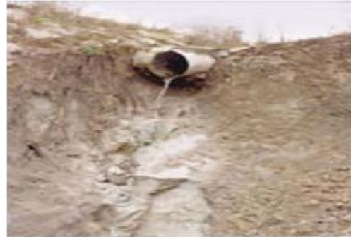
Concentration d'eau (érosion verticale).
