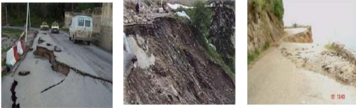
Figure 1.18 : Instabilités des talus (cas des routes).
