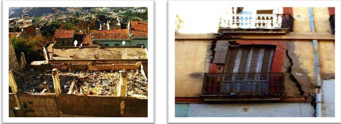
Figure1. 29 : Glissement de terrain à Belouizdad. [2002].
