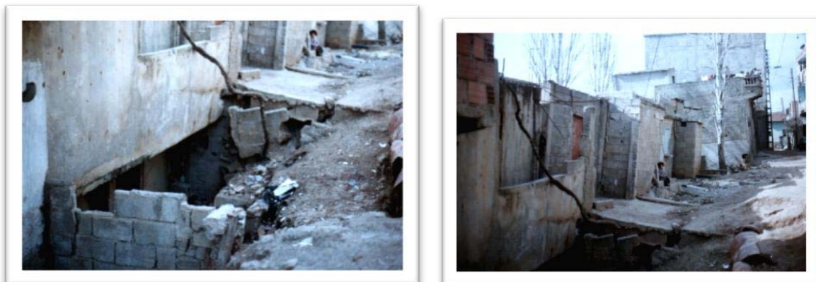
Figure 1.30 : Vue partielle d'un alignement de constructions ayant subi des basculements À Boudraa Sala
