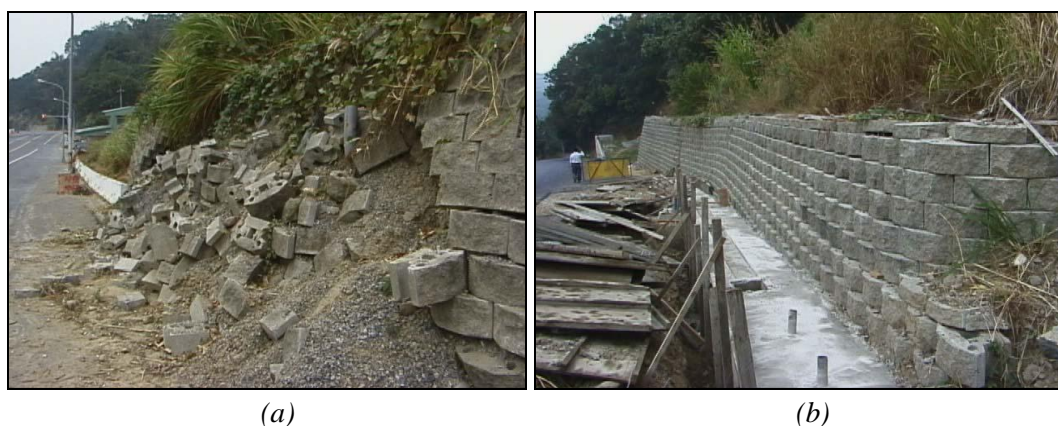
Fig.3.15. Sections d'un mur de soutènement en sols renforcés par géosynthétiques dans la route Ta Kung129 (Taiwan), (a) section endommagée, (b) section non endommagée.
