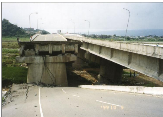
Fig.3.13. Effondrement de pont Wu-Shi (Taiwan).
