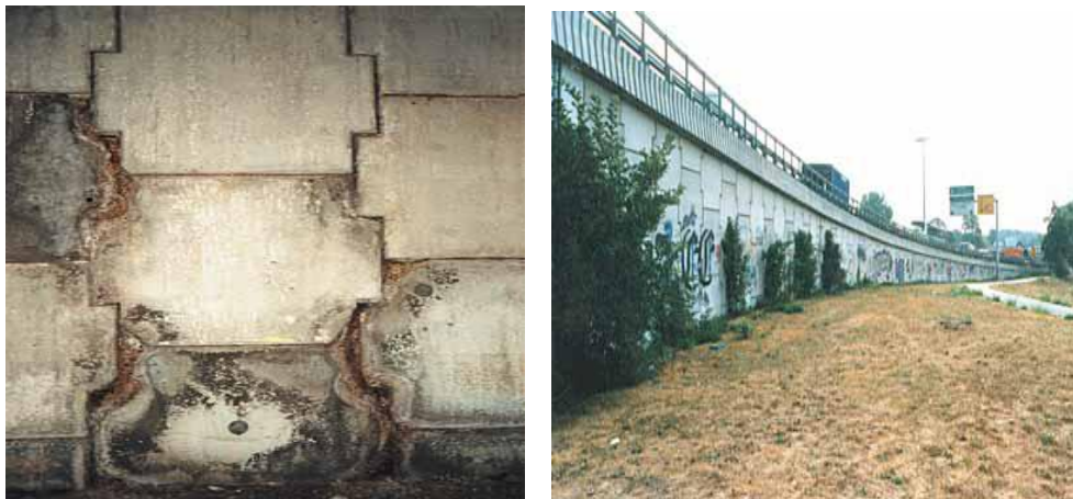
Fig.1 .18. Dégradation du béton d'une écaille par réaction sulfatique externe et défaut d'entretien.
