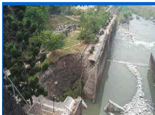
Fig.3.14. Dommages sur un mur de soutènement en sol non renforcé (Taiwan).
