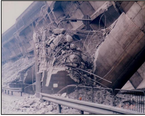
Fig.3.7. Défaillance d'une colonne en béton armé, Viaduc Fukae.
