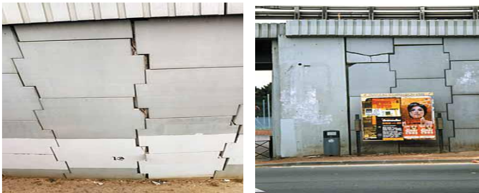
Fig.1 .16. Mouvement d'écailles dus à un tassement différentiel, sans et avec fracturation du parement.
