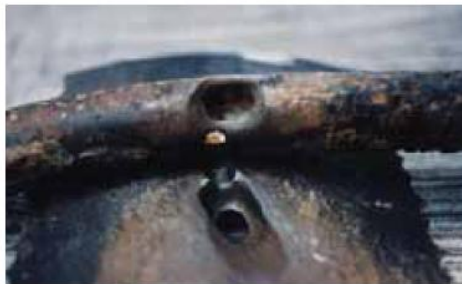
Fig. I.2: Corrosion par piqure
